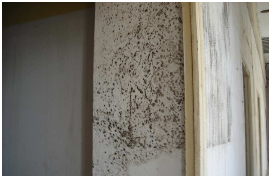
Muffe e microorganismi causati dall'infiltrazione delle acque
