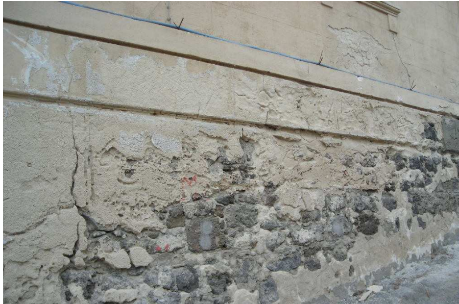
Parete ammalo rata dell'edificio (causa delle muffe interne)
