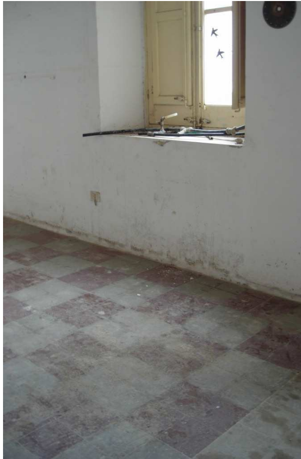
Pavimenti non a norma e mancanza di lambry
