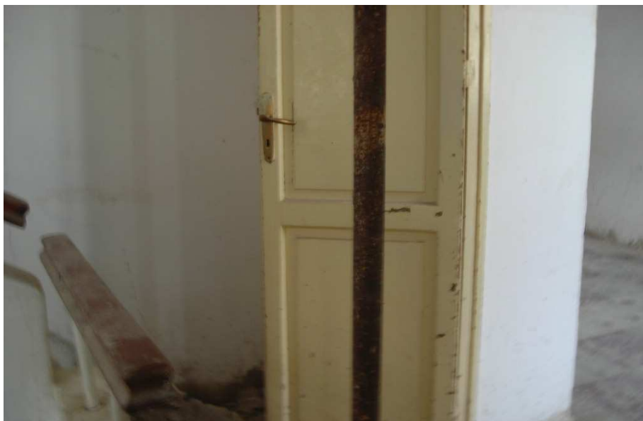
Vie d'esodo, con apertura degli infissi ad ostacolarne lo scopo
